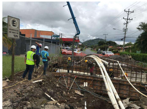
Imagen No.4. Colada de parte de muros y aletones de alcantarilla aguas arriba. Qda Cima.
