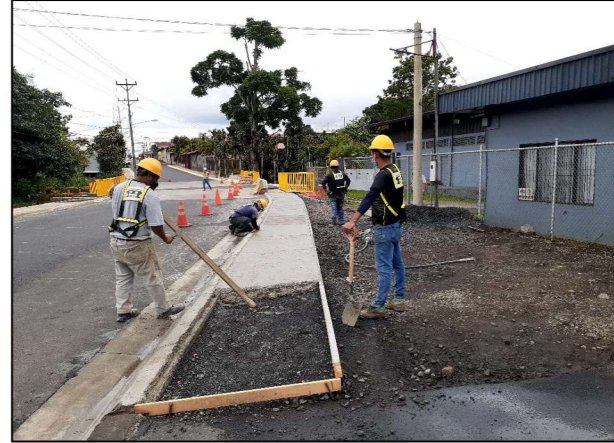
Fotografía 2. Construcción de acera en LD de aproximación margen izquierda de Qda. Cima.
