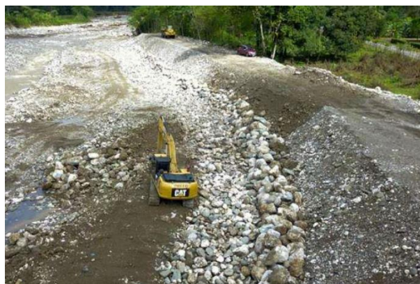
Figura 44. Construcción de obras de contención. Fuente: Ing. Gustavo Castro Chaves de la Gerencia de Conservación de Vías y Puentes.
