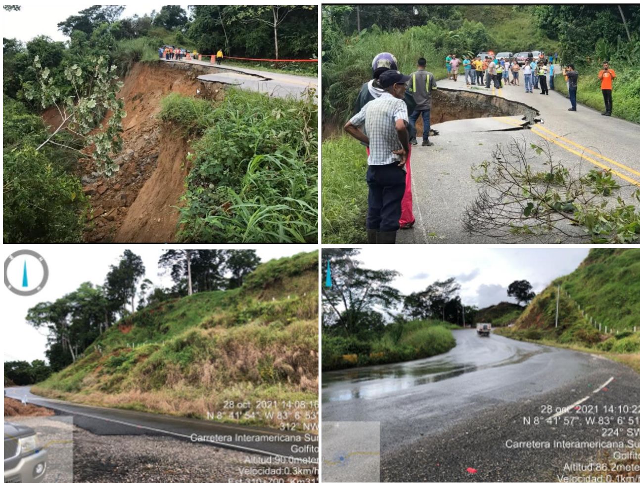
Figura 33. Ruta N.º 2 (Interamericana Sur), estacionamiento: Km 310+700, conocido también como “kilómetro 31”. Las imágenes superiores muestran un daño registrado en el 2017, mientras que en las inferiores se brinda el estado actual del sitio. Se identifican obras de drenaje insuficientes. Fuente: aplicación de campo Survey123®, CONAVI 2020 e información adicional suministrada por el ingeniero Gustavo Castro Chaves, Zona de Conservación Vial 4-3
