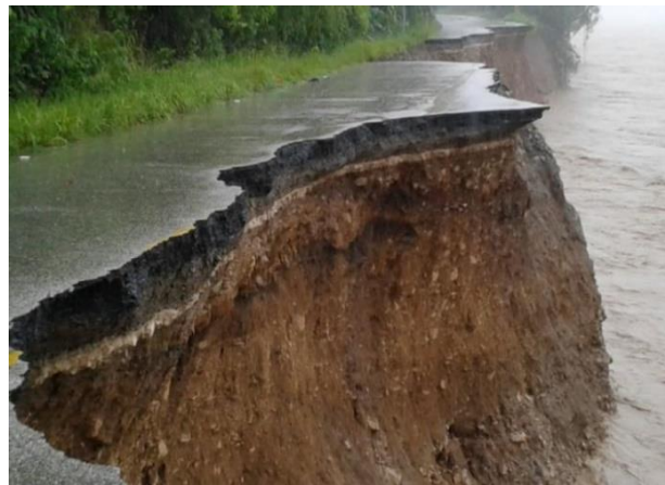
Figura 1. Socavación en la Ruta N°2 por avalancha en el río Grande de Térraba. Fuente: CRhoy.com, octubre 2017.
