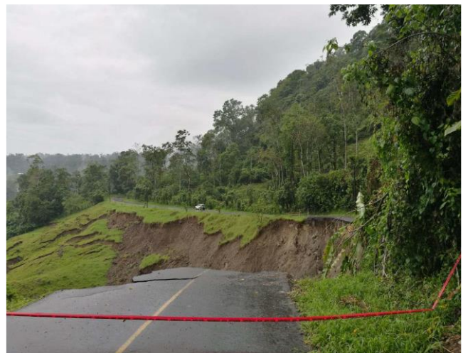
Figura 49. Situación después del colapso. Situación actual. Paso completamente cerrado. Fuente: aplicación de campo Survey123®, CONAVI 2020
