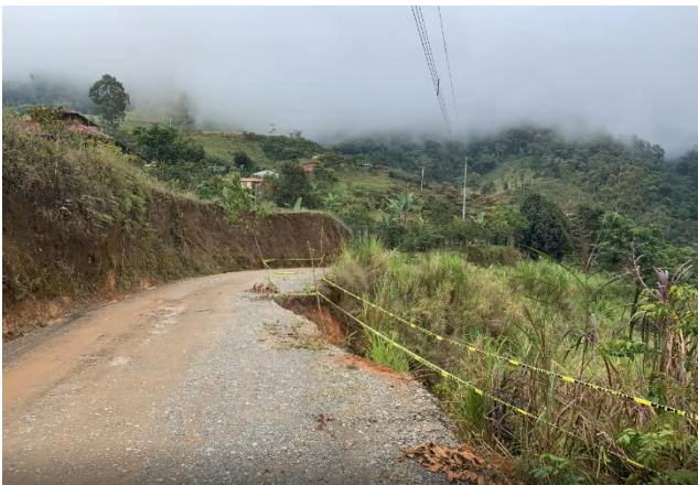
Figura 31. Ruta N.º335, estación km 11+000. Santa Eduvigis, Pérez Zeledón. Falla de borde, donde un estrato superficial de menor competencia (suelo), rota sobre uno más rígido (transición a basamento sedimentario local). Colaboración del ingeniero geotecnista Luis Carlos Brenes Robleto, Dirección de Diseño de Vías y Puentes. Fuente: aplicación de campo Survey123®, CONAVI 2020.
