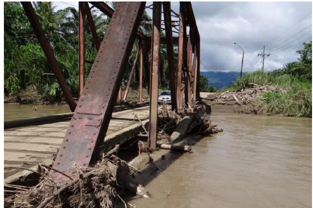
Figura 41. Estado de las cerchas del puente Amarillo, Ruta N.º 608. Fuente: Oficio DVP 17-2020-0506 de la Dirección de Diseño de Vías y Puentes.
