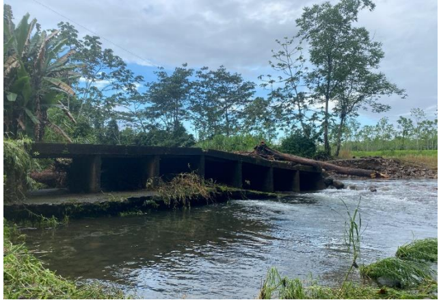
Figura 8. Colapso de alcantarilla, Ruta Nacional N.º 810, Zona 5-1 sector San Luis, abril 2021.
