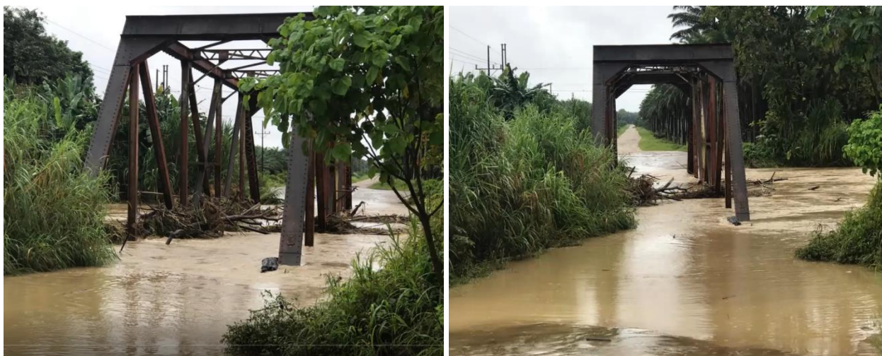
Figura 36. Puente conocido como Amarillo, Ruta N.º 608. Esta estructura se caracteriza porque el nivel del agua pasa todo el tiempo muy cerca de las cuerdas inferiores de las cerchas y se observa material de arrastre en contacto directo con el puente (oficio DVP 17-2020-0506 del 23 de diciembre de 2020), razón por la cual, ante cualquier evento hidrometeorológico, el río inunda el puente y sus rellenos de aproximación, siendo constantemente impactado por ramas y escombros que arrastra la corriente. Además, el mismo queda fuera de servicio mientras baja el nivel de las aguas. Según el SAEP, esta estructura se encuentra priorizada en el puesto N°576. Fuente: aplicación de campo Survey123®, CONAVI 2020.
