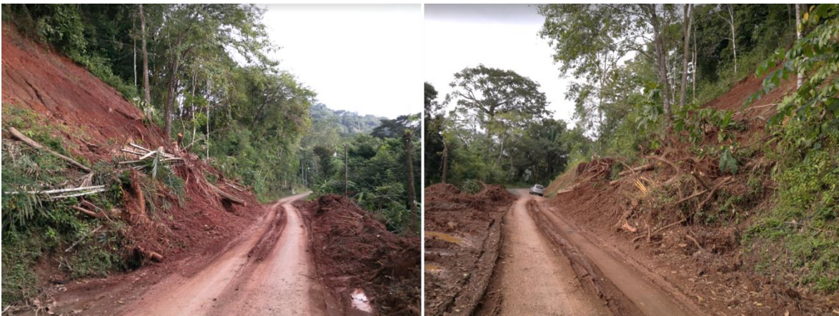
Figura 10. Deslizamiento que ocasiona obstrucción parcial de la Ruta. El paso fue regulado.
