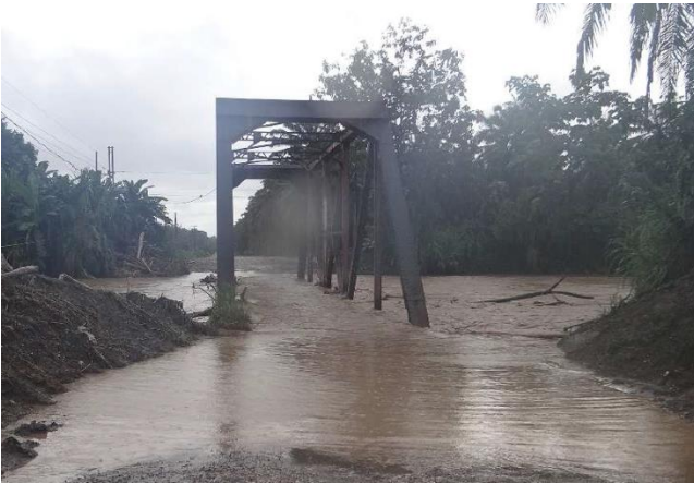
Figura 40. Vista de línea centro el 3 de diciembre de 2020 del puente Amarillo, Ruta N°608. Fuente: Oficio DVP 17-2020-0506 de la Dirección de Diseño de Vías y Puentes.
