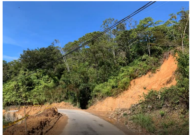
Figura 29. Ruta N.º 242, estación: Km 9+300, Talud inestable camino al cerro Chirripó. La ausencia de cunetas, genera un efecto negativo tanto en el talud de corte como en el de relleno.
