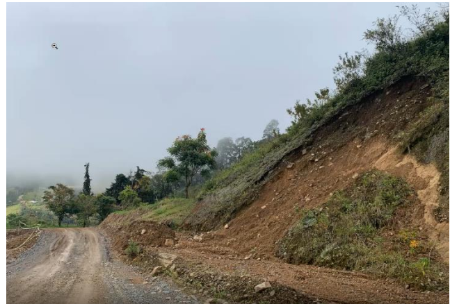
Figura 32. Ruta N.º 335, estación: Km 9+700. Se requiere de una intervención mayor que se sale de las competencias de un mantenimiento vial, con obras de terraceo, manejo de aguas, anclajes y cambiar el alineamiento de la vía. Es una ruta con un TPDA relativamente bajo, lo que podría afectar la rentabilidad del proyecto. Fuente: aplicación de campo Survey123®, CONAVI 2020
