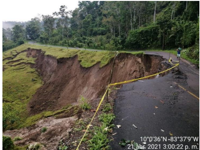
Figura 48. Situación después del colapso. Paso parcialmente cerrado, mismo que permitía el paso de peatones y vehículos de dos ruedas. Fuente: aplicación de campo Survey123®, CONAVI 2020.
