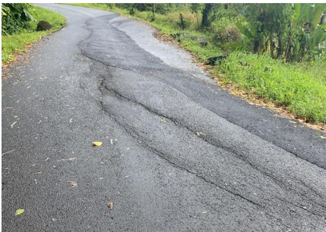
Figura 47. Situación antes del colapso. Fuente: aplicación de campo Survey123®, CONAVI 2020.
