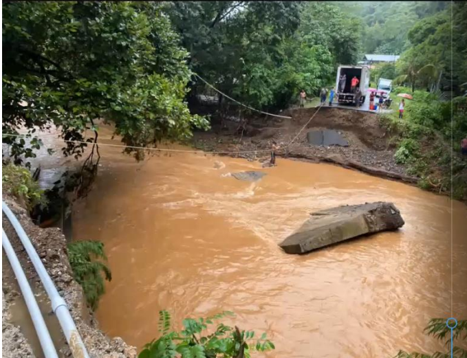
Figura 38. Ruta N.º 934. Río San Francisco. Puente colapsado. Antes del colapso, la estructura presentaba una fundación expuesta por socavación. Fuente: aplicación de campo Survey123®, CONAVI 2020.
