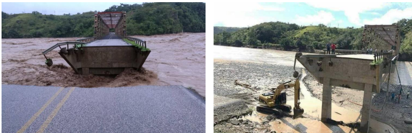
Figura 4. Puente sobre el río Grande de Térraba, durante y posterior la emergencia asociada a la Tormenta Tropical Nate. Fuentes: CRHoy y La Nación de octubre de 2018, respectivamente.
