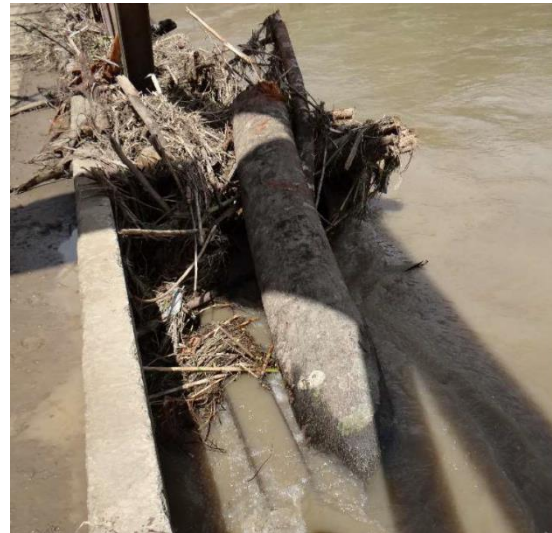
Figura 42. Tronco arrastrado por el río Corredor, puente Amarillo, Ruta N.º 608. Fuente: Oficio DVP 17-2020-0506 de la Dirección de Diseño de Vías y Puentes.
