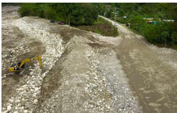
Figura 43. Restitución del relleno para la recuperación de la vía. Fuente: Ing. Gustavo Castro Chaves de la Gerencia de Conservación de Vías y Puentes.
