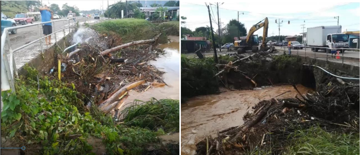
Figura 37. Ruta N.º 2. Quebrada Chiricana. Una empalizada aguas arriba, aproximadamente 10 metros antes de la batería de alcantarillas, podría atrapar el material que arrastra la quebrada. No obstante, una medida definitiva podría ser la construcción de una nueva estructura de puente, que permitiera el paso de todo ese material. Fuente: aplicación de campo Survey123®, CONAVI 2020.
