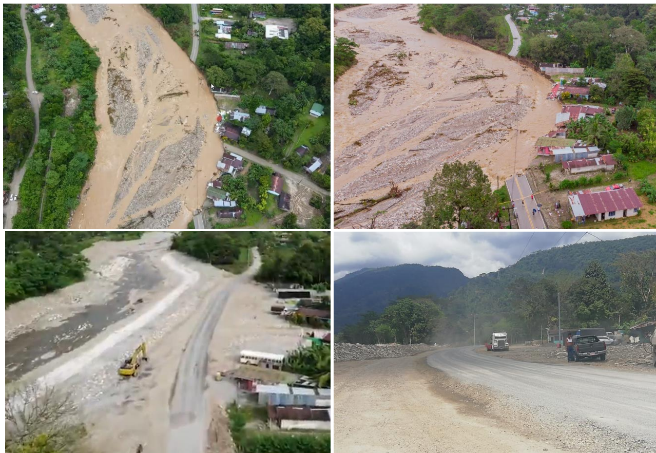
Figura 34. Ruta N.º 237, sección: Ciudad Neily – Fila de Cal. Colapso de la vía producto de que el río Caño Seco arrasó completamente con un tramo de la carretera. Se reconstruyó nuevamente el tramo con las obras de protección que permiten salvaguardar la infraestructura construida y encauzar las aguas del río. Estas medidas no se pueden considerar como de carácter definitivo, porque el problema es que esta sección de la ruta invade la llanura de inundación del río (ver apartado 4.3 de este Plan). La solución definitiva exige modificar el trazado de la ruta. Fuente: aplicación de campo Survey123®, CONAVI 2020
