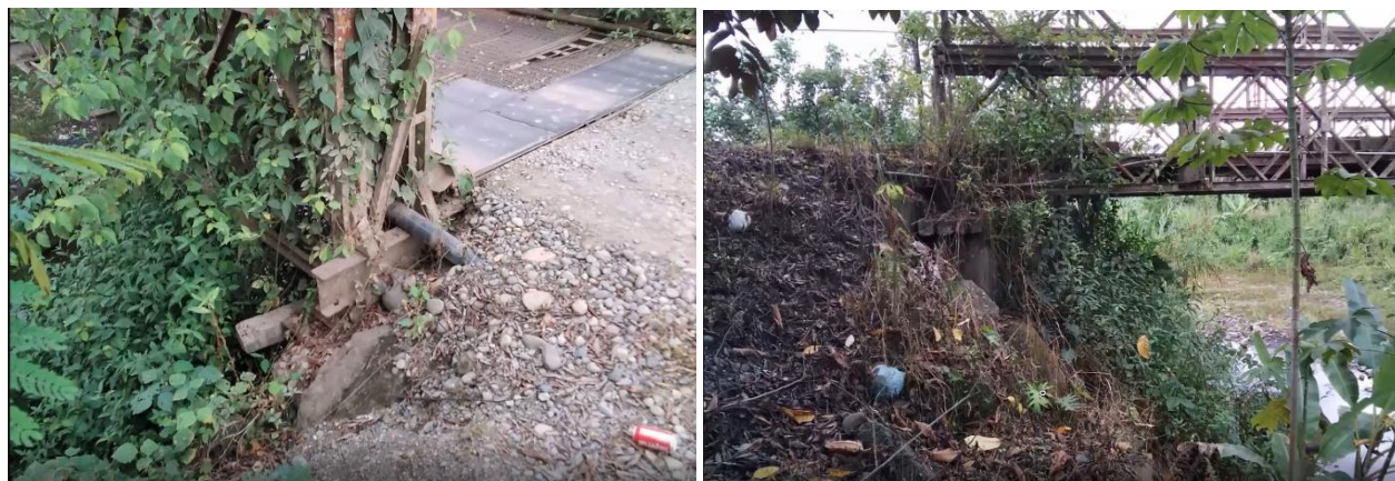
Figura 35. Ruta N.º 801. Puente modular denominado como Uatsi. Se registra un problema de socavación en su relleno de aproximación. No obstante, en todas las imágenes se refleja un serio problema asociado con su mantenimiento. Por otra parte, este mismo daño ya se había reportado en el SAEP desde años atrás.
