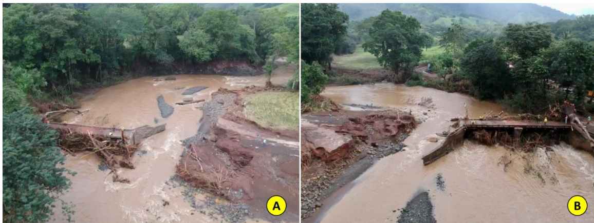
Figura 9. Colapso relleno de aproximación del puente sobre río Lajas, Ruta Nacional N.º 901, Zona de Conservación 2-4. A: fotografía aguas arriba (nótese acumulación de escombros en el puente). B: fotografía aguas abajo. Se evidencia el cambio del cauce producto del colapso del relleno de aproximación. Fuente: aplicación de campo Survey123®, CONAVI 2020.
