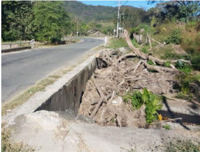
Figura 5. Obstrucción de alcantarilla en la quebrada Vainilla, Ruta Nacional N.º 160. Fuente: CONAVI.
