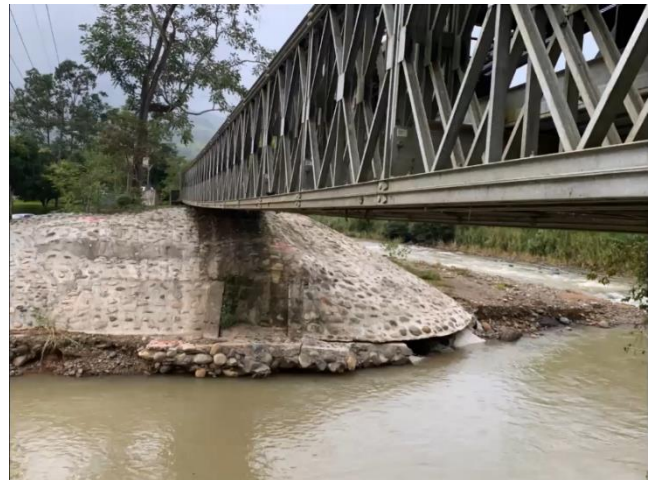
Figura 39. Ruta N.º 243, puente modular sobre río Pedregoso, Pérez Zeledón. El debido monitoreo de la estructura, generó que se detecte a tiempo un problema de socavación en las protecciones del bastión de la estructura. Fuente: aplicación de campo Survey123®, CONAVI 2020.
