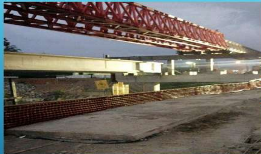
Viga No.2 instalada y ajuste de Lanza Vigas para el montaje de la Viga No.3 (Tramo No.3)
