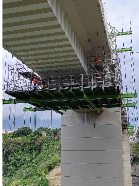
Foto No. 5: Trabajos para reforzamiento exterior de puente mediante fibra de carbono. Proyecto rehabilitación del puente sobre el río Virilla en la Ruta Nacional No. 32
